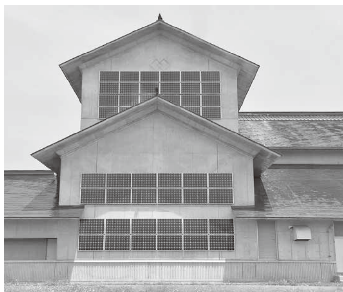
再生可能エネルギー = フレンドリープラザのソーラーパネル(南側)
